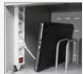
Organización eléctrica con regletas de tomas schucko.
