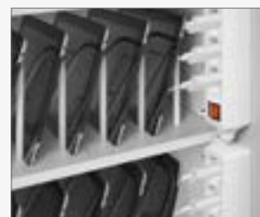
Organización eléctrica con regletas de tomas schucko
