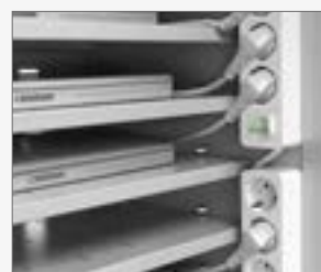
Organización eléctrica con regletas de tomas schucko
