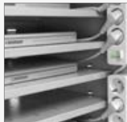
Organización eléctrica con regletas de tomas schucko
